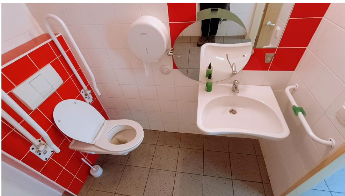
Obrázek č. 24 – Gymnázium Náchod – bezbariérové toalety s nevhodným uspořádáním vybavení, které především díky zděnému systému splachování neumožňuje správný přístup k toaletě
