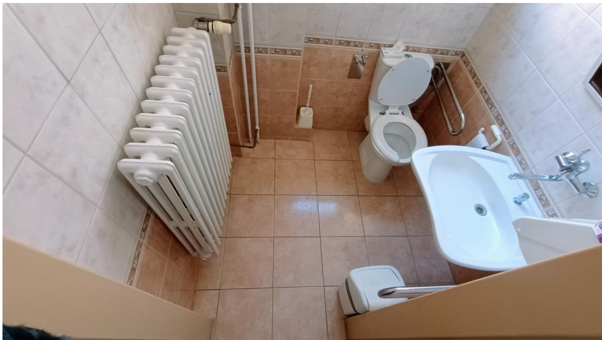
Obrázek č. 12 – Gymnázium Nová Paka – bezbariérová toaleta má nedostačující prostorové rozměry a chybějící sklopné madlo
